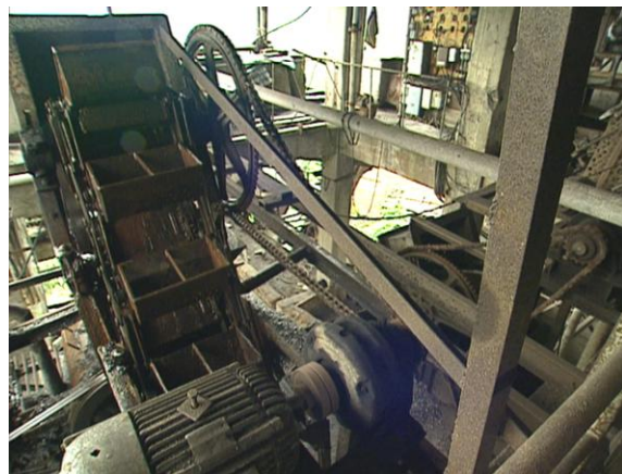
— 洗煤場輸送煤斗 —
