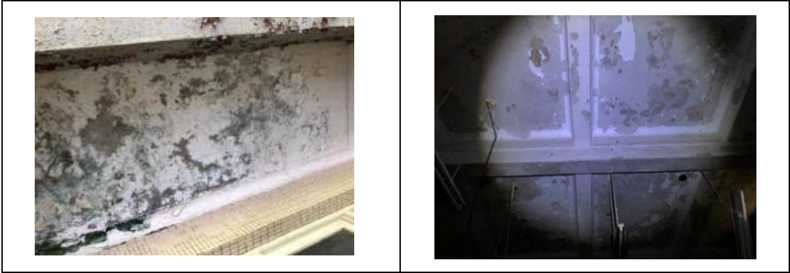
樓板白華滲水
