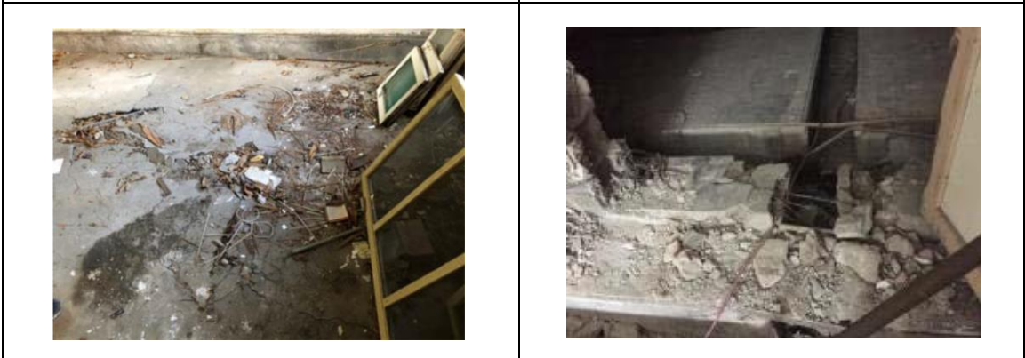
地坪鼓脹破損
